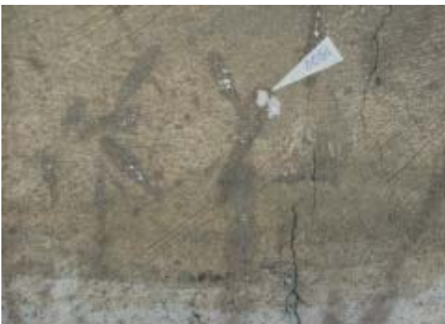
Abb. 3a, b Entnahme der Probe 0051 in der Sockelzone, in der keine Übermalungen vorgenommen wurden und in der die „Spritzer“ durch mikrobielle Besiedlung bereits im sichtbaren Licht zu erkennen sind.
